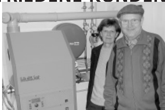
Fam. Radinger, Lambach, mit neu saniertem Öl-Brennwertkessel
